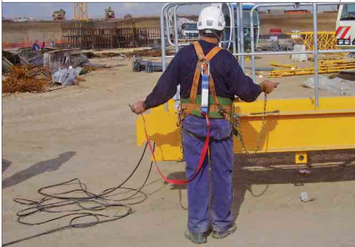
Montatore che indossa una imbracatura per il corpo con incorporata una cintura di posizionamento. E' visibile il cordino con dissipatore di energia e il cordino di posizionamento a maglie di catena
