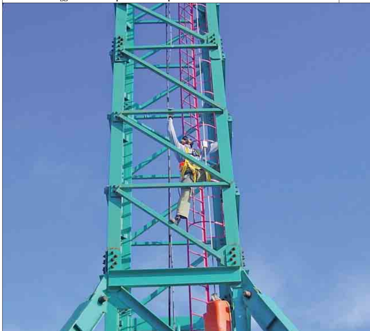
Linea di ancoraggio flessibile in posizione reale per risalire l'elemento e sistemare la scala interna
